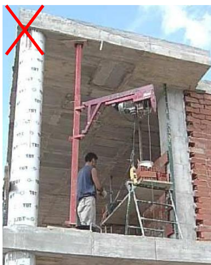
Trabajador con riesgo de caída a distinto nivel.
