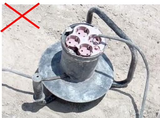
Prolongador que ha perdido en parte su aislamiento eléctrico
