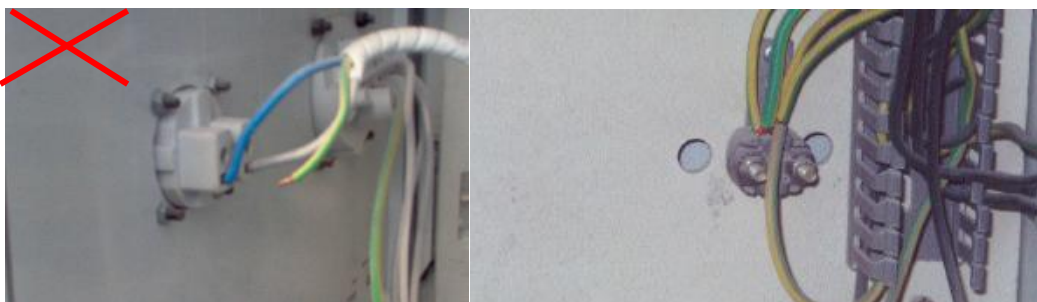
En la fotografía de la izquierda se ha interrumpido la continuidad del conductor de puesta a tierra
